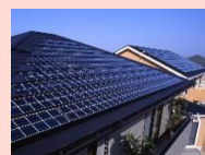
太陽光発電システム
