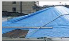
ブルーシート・土のう袋
