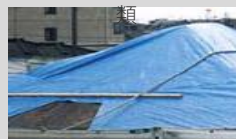
ブルーシート・土のう袋
